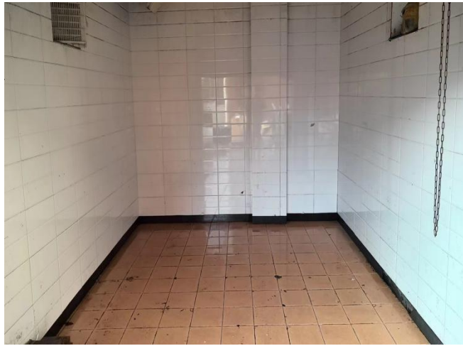
一般固体废物暂存间
