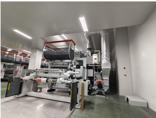
1号厂房印刷、复合废气收集设施
