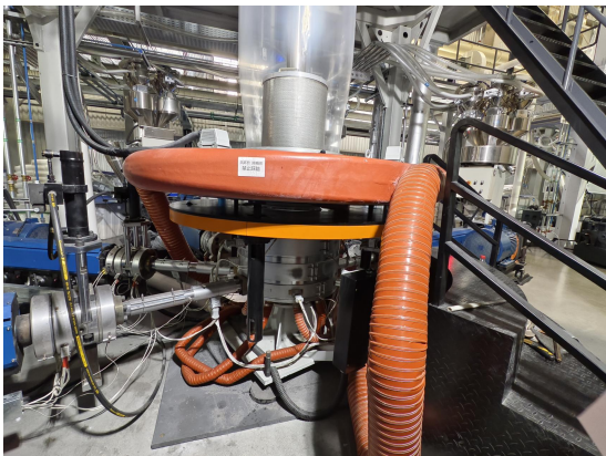
1号厂房挤出废气收集设施风环
