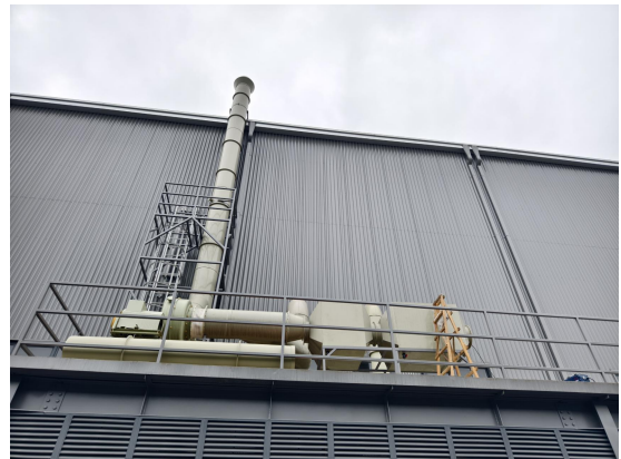
1号厂房挤出废气处理设施二级活性炭+15m排气筒
