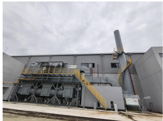
1号厂房印刷、复合废气处理设施RTO+20m排气筒
